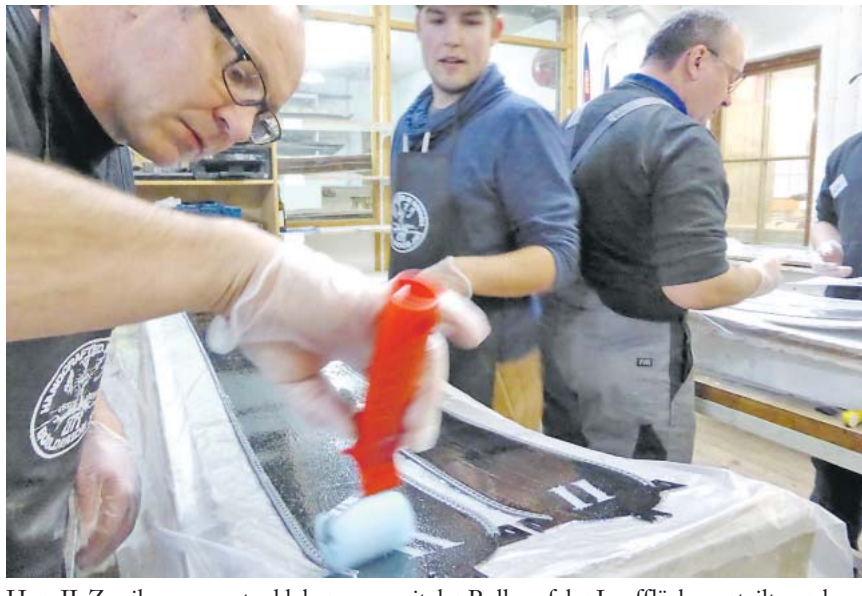
Harz II: Zweikomponentenkleber muss mit der Rolle auf der Lauffläche verteilt werden.
